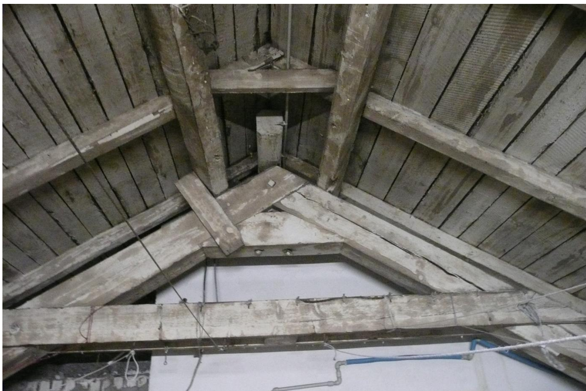
FOT.5 Widoczne pęknięcia ram drewnianych , widoczne uszkodzenia płatwi przez grzyby ( lewa płatew).
