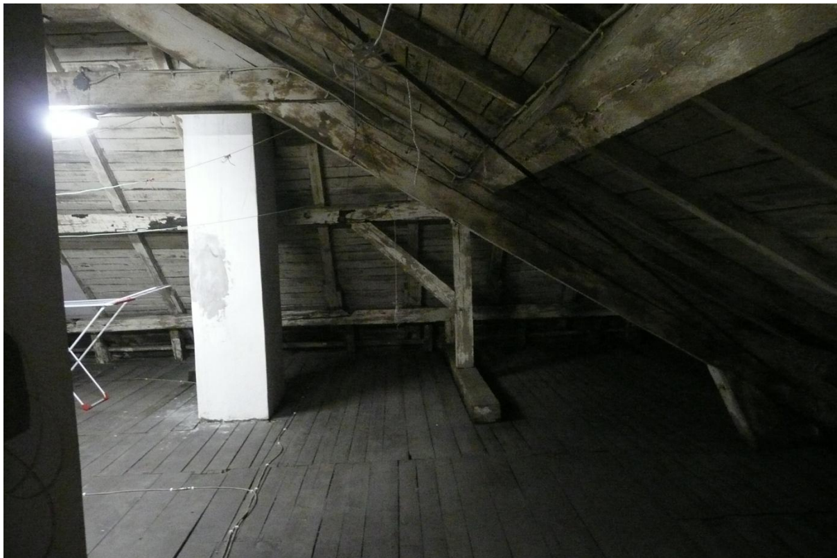
FOT.3 Widoczne zacieki na krokwiach i płatwiach
