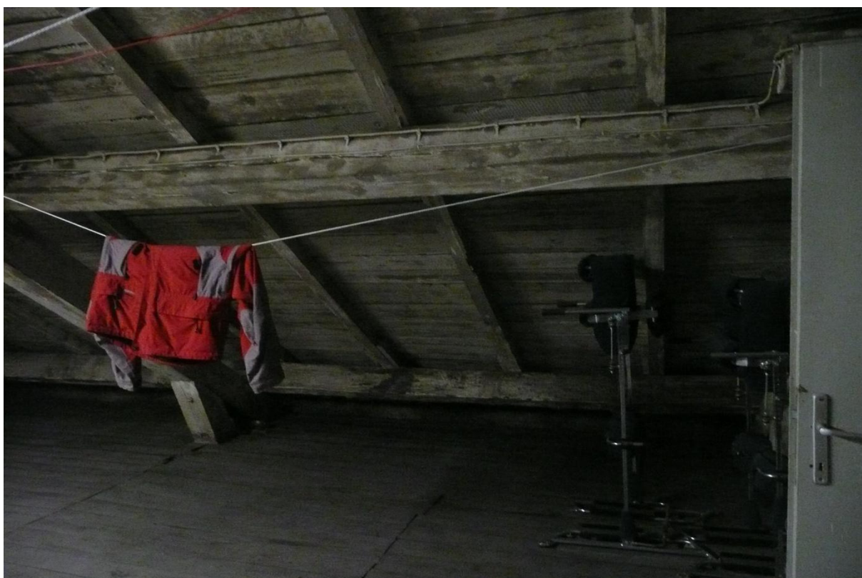
FOT.1 Widoczne zacieki i pęknięcia płatwi dachowych
