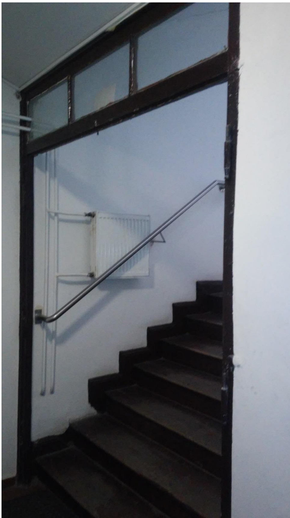
STARA ŚCIANKA WIATROŁAPU DO USUNIĘCIA
