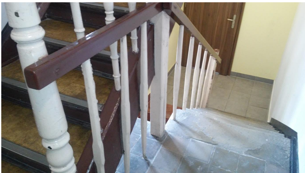
BALUSTRADA DREWNIANA DO WYMIANY, PODEST I SCOADY DO REMONTU
