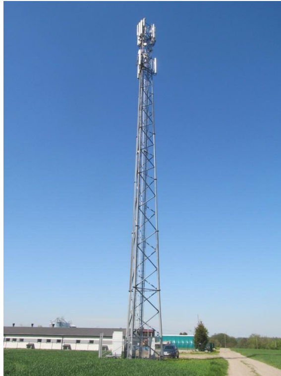
Zał. nr 1: Widok ogólny instalacji radiokomunikacyjnej.
