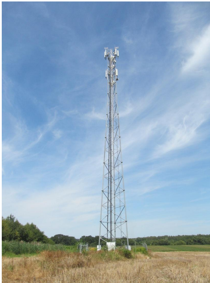
Zał. nr 1: Widok ogólny instalacji radiokomunikacyjnej.
