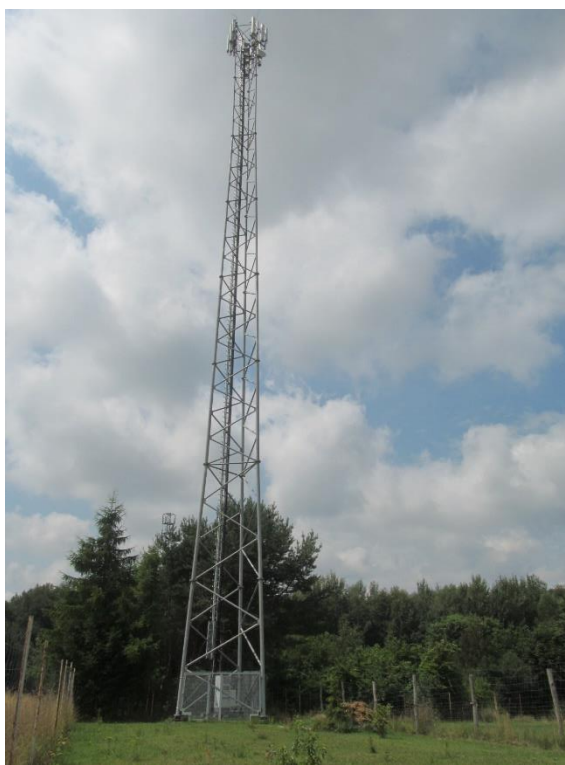
Zał. nr 1: Widok ogólny instalacji radiokomunikacyjnej.
