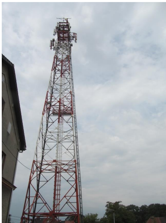
Załącznik nr 1: Widok ogólny instalacji radiokomunikacyjnej.
