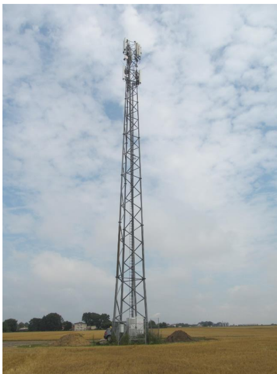
Zał. nr 1: Widok ogólny instalacji radiokomunikacyjnej.
