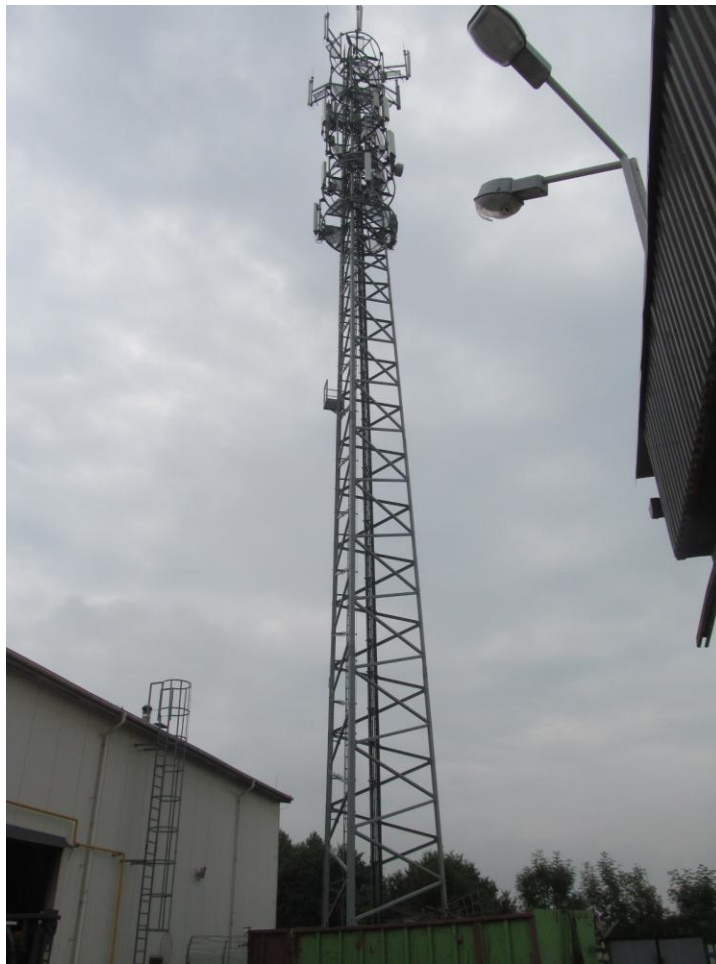
Zał. nr 1: Widok ogólny instalacji radiokomunikacyjnej.
