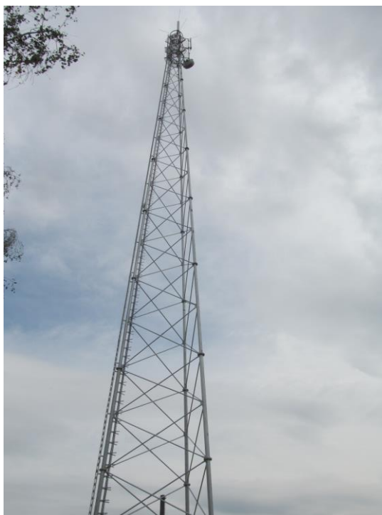
Zał. nr 1: Widok ogólny instalacji radiokomunikacyjnej.
