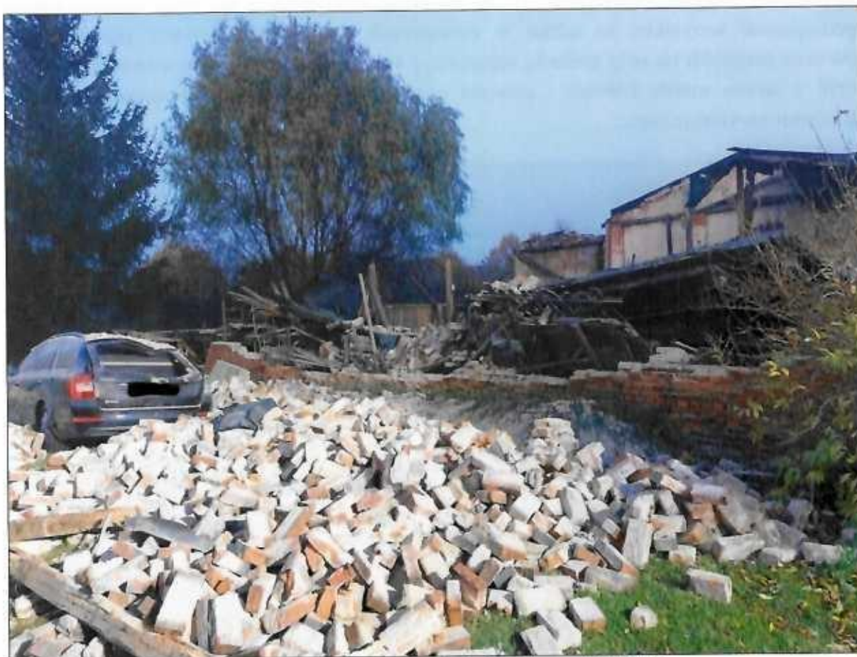
Fotografia 11 Zawalona ściana budynku, Gliwice, 08.11.2022 r.
